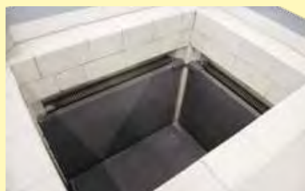
Revestimiento de los laterales y del suelo con placas de carburo de silicio como protección en el horno de cuba S 73/HS
